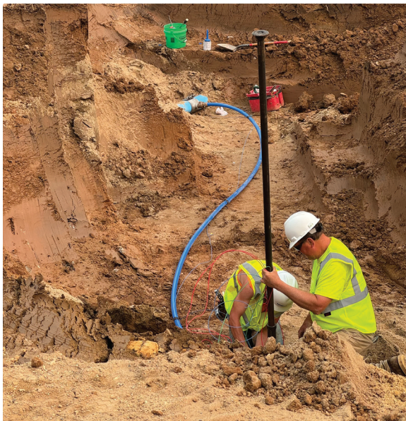
Figure 11 : Installer les tuyaux ServicePEX en serpentin, en laissant assez de jeu pour permettre la contraction de la tuyauterie due aux changements de température avant le remblayage.
