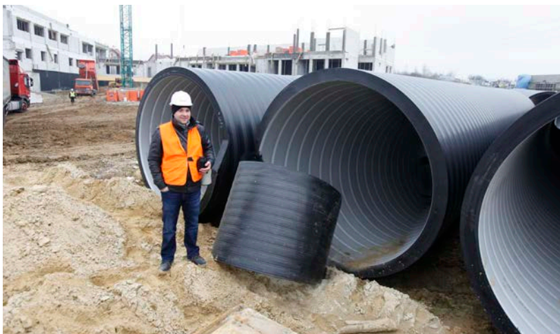
Retencyjny kanał ściekowy na osiedlu Krakowska-Południe w Rzeszowie
