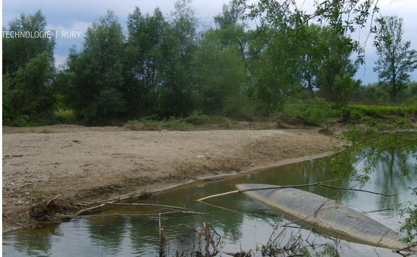
Ryc. 2. Kolektor dosyłowy PE do oczyszczalni ścieków w Nowym Sączu podczas powodzi w 2010 r. (DN 1400, 3,4 km, rok budowy 1995), fot. K. Kudlik [7]
