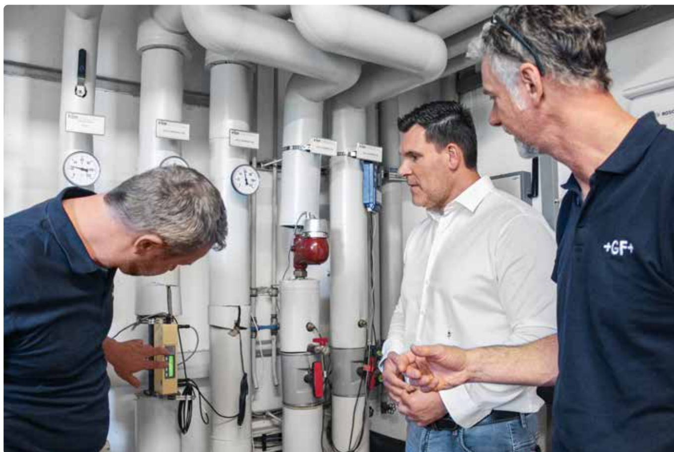
Manuel Kächler (links) und Ralf Schirmer (rechts) erklären Bürgermeister Martin Krämer die Funktionsweise von GF EcoMate im Heizungskeller der Sixtus-Bachmann-Grundschule in Obermarchtal.
